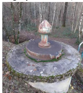
Réservoir 200m 3 Avrigney
